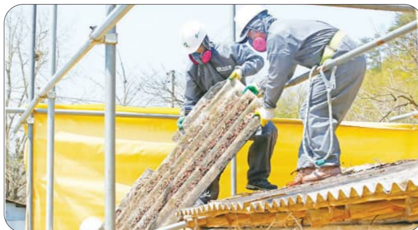
임실군이 발암물질인 석면으로부터 주민의 건강을 보호하고 생활환경 개선을 위해 슬레이트 철거 및 지붕개량 사업에 대규모 예산을 투입한다.
